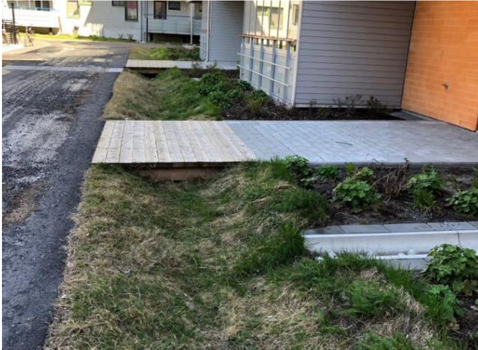
Figur 12. Utkastare med lökränna till svackdike inom kvarter för trög avledning av dagvatten, träbro till entréer Bildkälla: WSP Umeå
